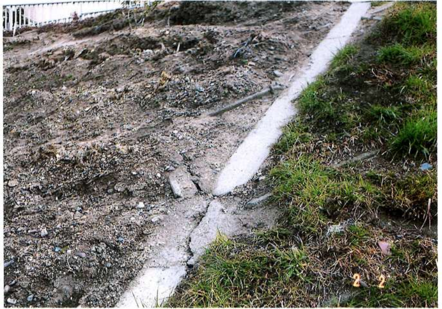
写真(91) 損傷を受けた法面部分
