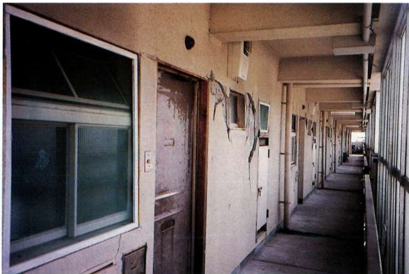
写真(39) 廊下側外壁(雑壁)の損壊
