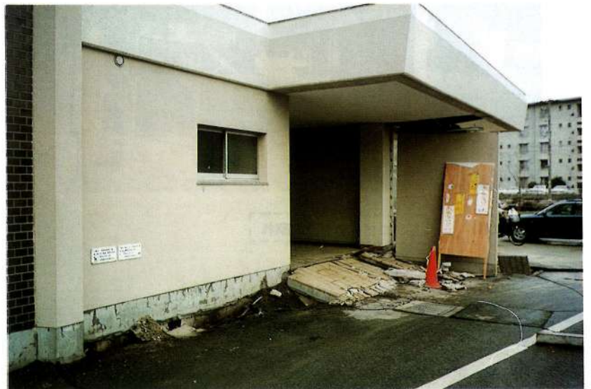
写真(46) 1階建物廻りの地盤沈下
