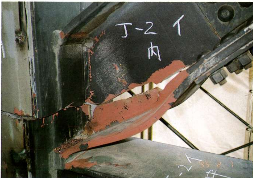
写真(芦-24) 主柱及び斜材鉄骨の破断
