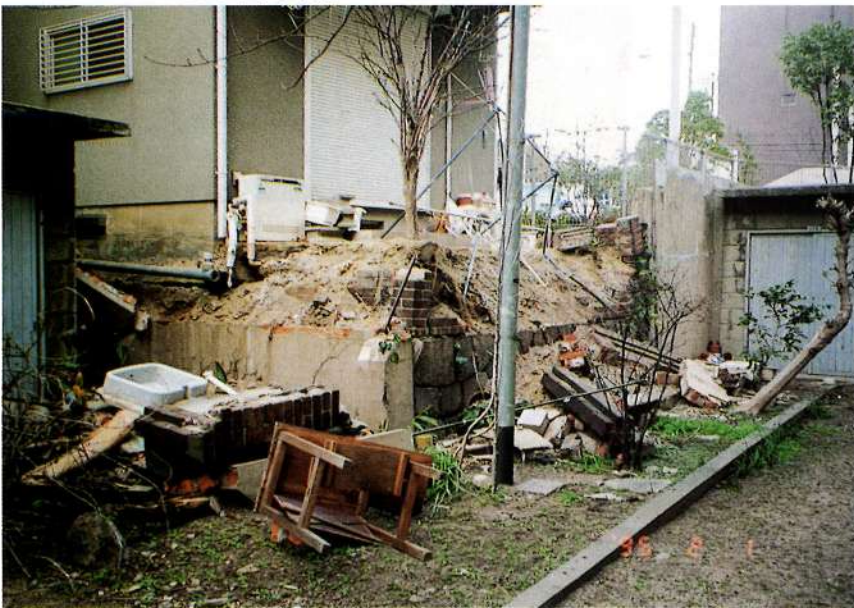
隣接境界塀の倒壊
