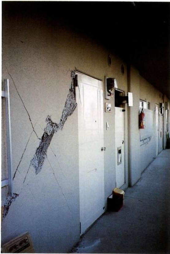
写真(43) 廊下側外壁(雑壁)の損壊
