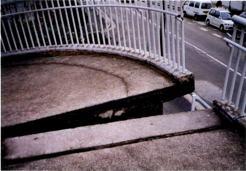
写真(芦-5) 歩道橋の傾斜
