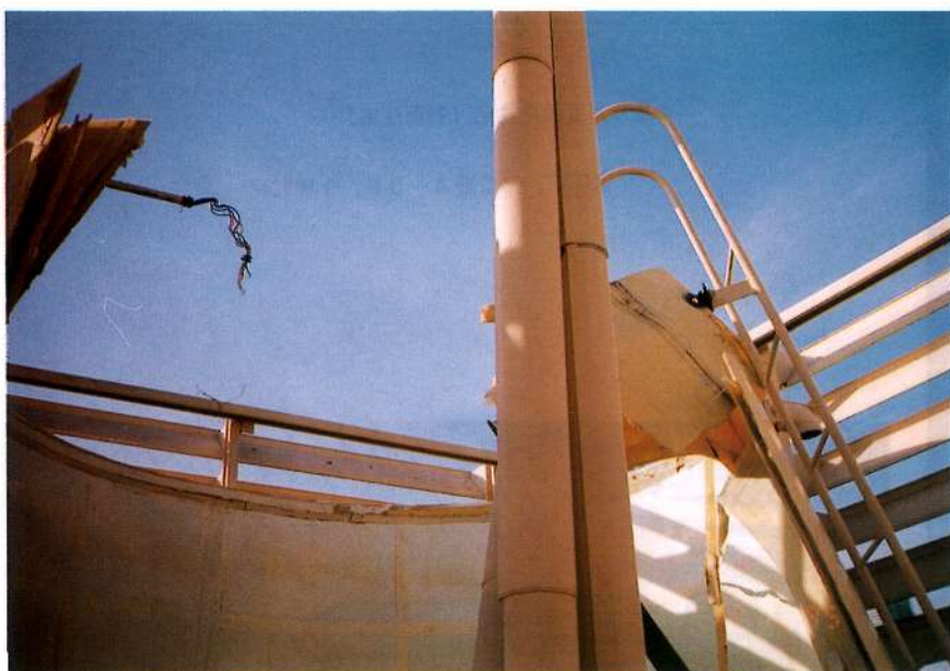
写真(98) 高置水槽の破断
