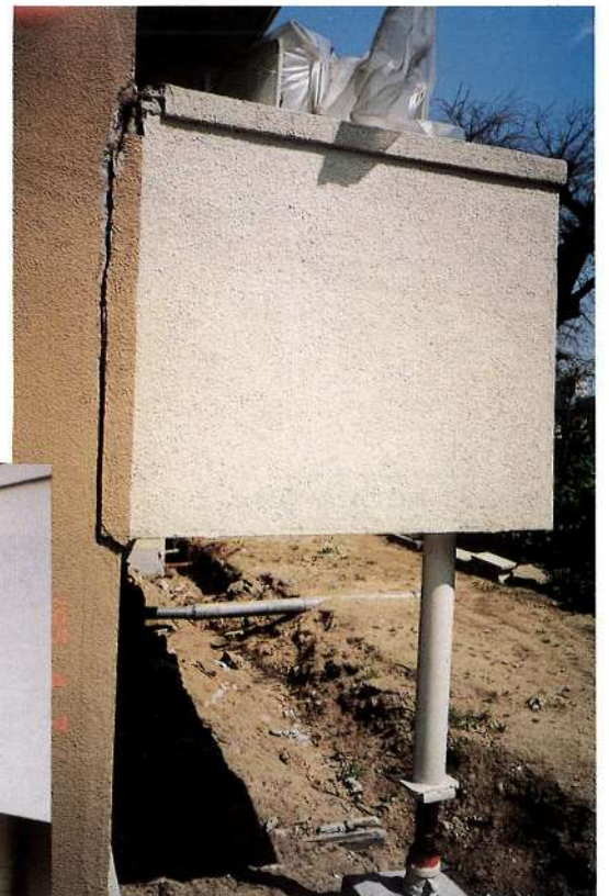
バルコニー手摺壁のクラック
