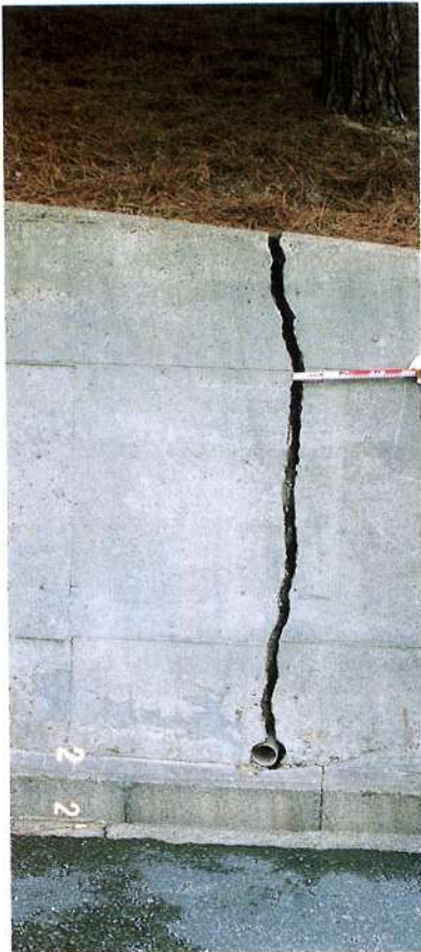
写真(92) コンクリート擁壁のクラック
