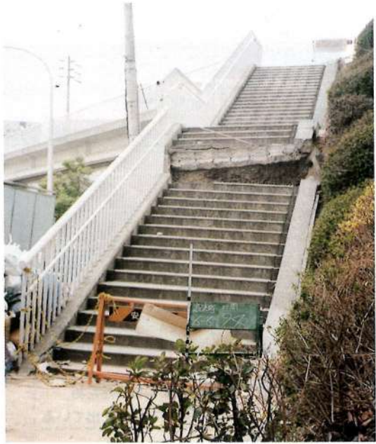
階段一部損壊 写真(芦-6)
