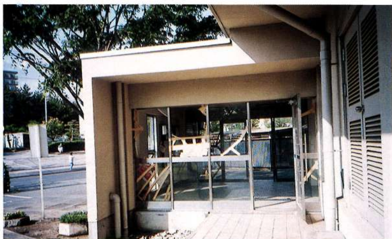
写真(41) EVロビーのガラス割れ
