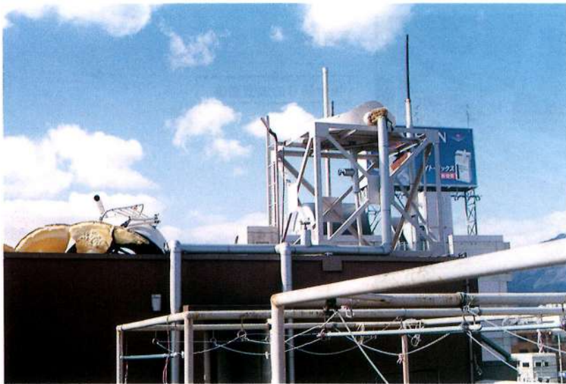
写真(97) 高置水槽の破断
