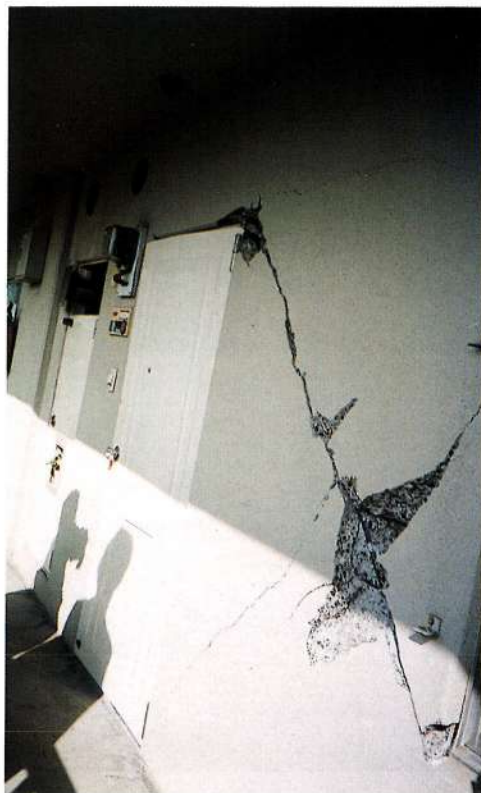
写真(42) 廊下側外壁(雑壁)の損壊
