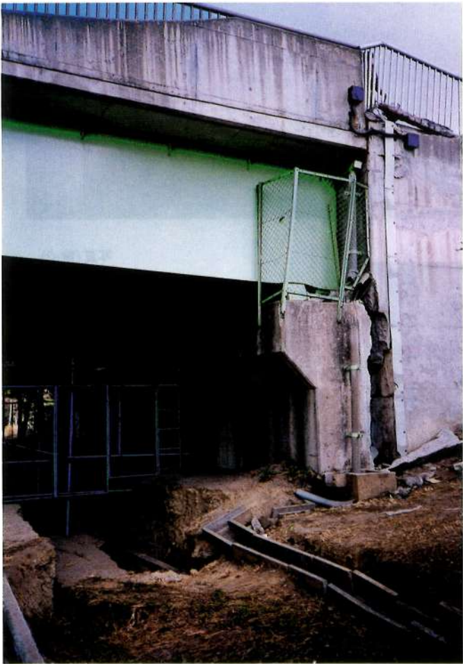
写真(芦-7) 宮川大橋の柱脚部の損壊
