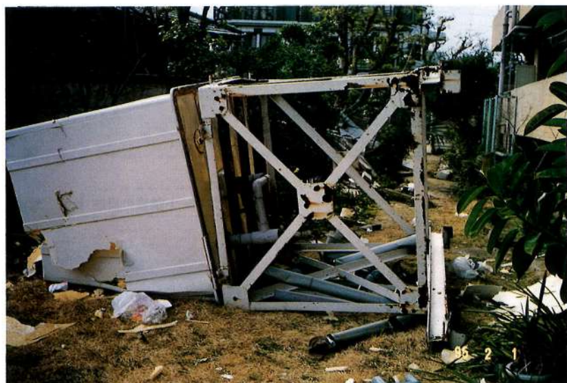
写真(99) 高置水槽架台共に転落
