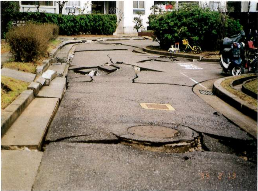
アスファルト舗装の損壊 写真(芦-8)
