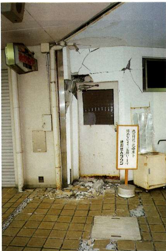
写真(45) 1階店舗の便所廻りの損壊
