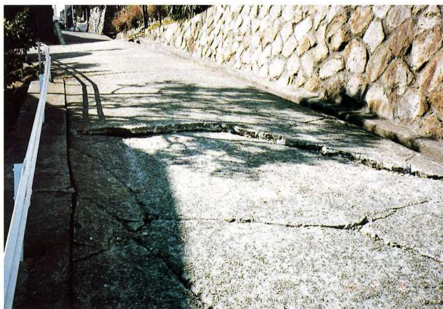
コンクリート舗装の損壊
