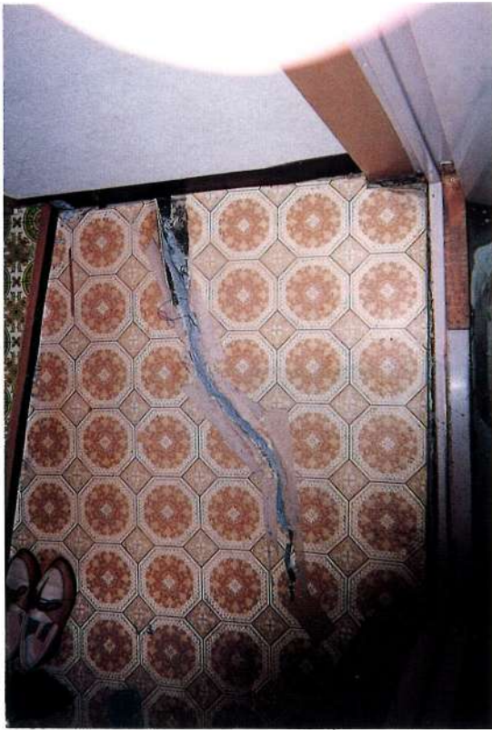
写真(50) 玄関床の割れ
