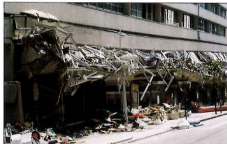
1~3F事務所部分崩壊
