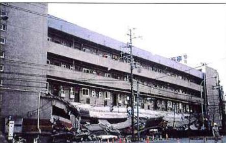
1F店倉庫部分崩壊
