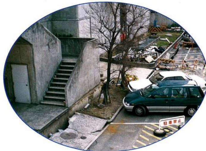
業務施設棟周辺の地盤沈下
