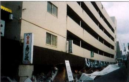
1F店舗部分崩壊
