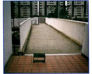
歩道橋のずれ
