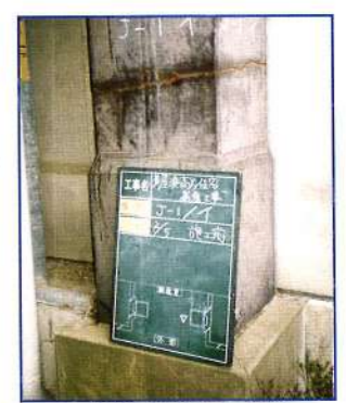
主柱鉄骨(柱脚部)の破断
