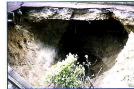
緑道の陥没(高層地区)
