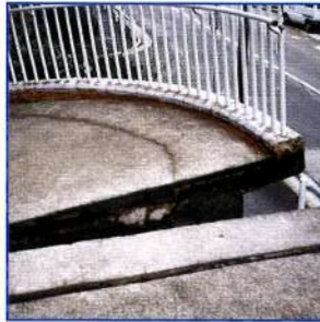
歩道橋の傾斜
