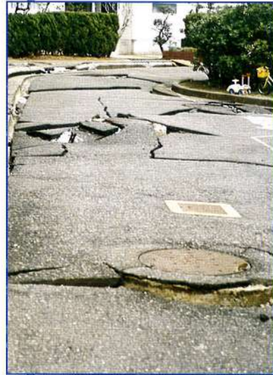
アスファルト舗装の損壊
