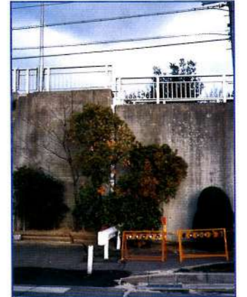
段差の出来た擁壁(潮見町)
